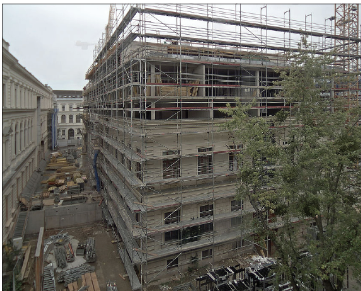
Abb. 6: Stand der Bauarbeiten von Süden gesehen am 4. September 2018; links das Universitäts-Hauptgebäude, rechts die Bibliothek, dazwischen wird die neue Eingangshalle entstehen (Foto: Universität Graz)
