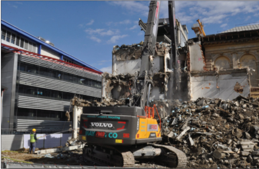
Abb. 3: Große Teile des alten Gebäudes sind nur mehr Schutt. Links das ReSoWi-Gebäude, rechts im Hintergrund die alte Fassade aus dem 19. Jahrhundert (Foto: Robert Ramschak)
