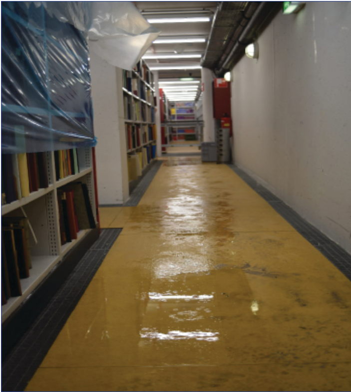
Abb. 5: Wassereintritt am Tag der Eröffnung (Foto: Universitätsbibliothek, Robert Ramschak)
